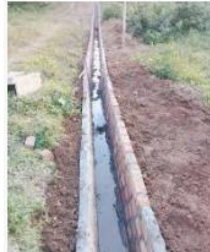
Warga Kecewa Drainase Dik... aksipost.com
